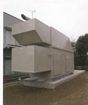
震災後導入した発電機
