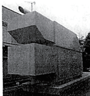
本社・工場に設置された大型自家発電機
