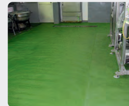
食品工場施工例(防滑グリーン)
