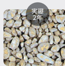
エポキシ系 自然石舗装材の劣化
